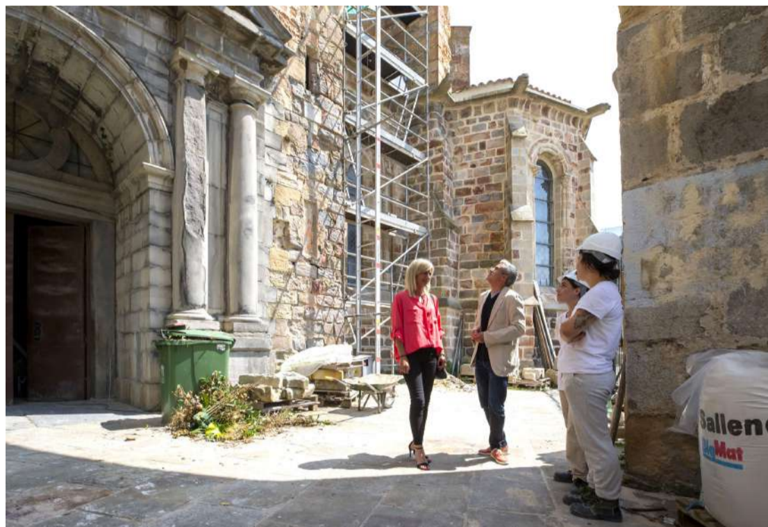
Zuloaga y Herrán, delante de las obras que se están ejecutando en los muros exteriores de la iglesia Santa María.
